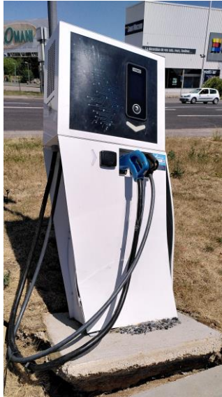
Figure 1 : protection contre les collisions insuffisante
