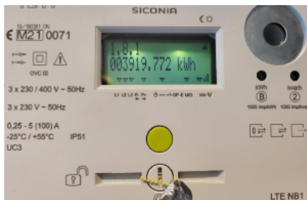
Pour une connexion triphasée de 400 V, L1, L2 et L3 sont indiqués sur le compteur numérique
