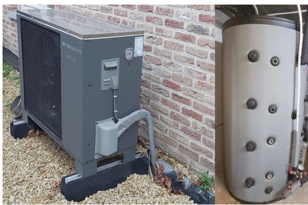
Een woning met warmtepomp en boiler werd als use case gebruikt om technologieën en regel-algoritmes te testen in reële omstandigheden
