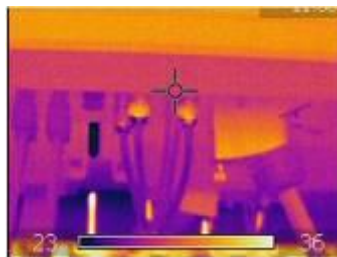
Figure 36 - Echauffement des branchements de câbles dans l'onduleur
