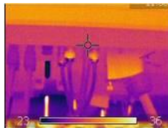
Figure 36 - Echauffement des branchements de câbles dans l'onduleur
