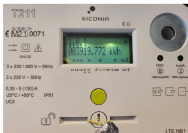
Voor een driedfasige 400 V-aansluiting worden L1, L2 en L3 op de digitale meter aangesloten
