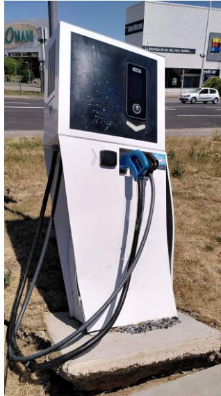
Figure 1 : protection contre les collisions insuffisante
